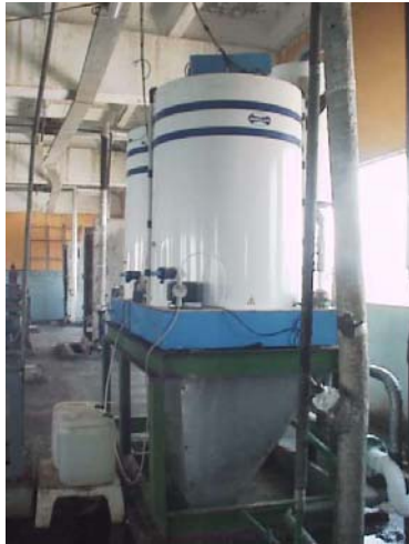
Fig. 1 Vista general del Generador
