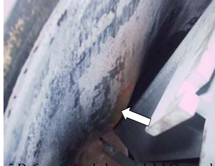
Fig. 5 Deformación de la pared del Generador N°1
