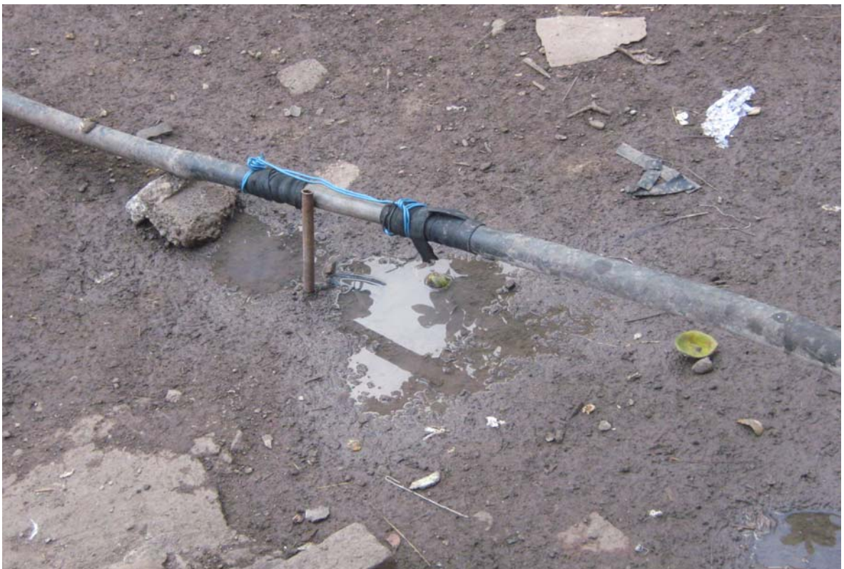
Salideros de agua que provoca el despilfarro.
