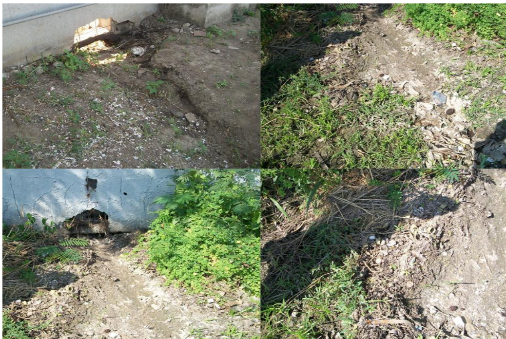
Fig. 3.6- Orificios por donde escurren las agua pluviales al exterior del patio
