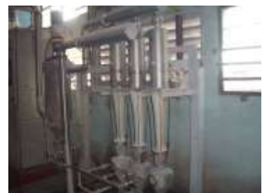
Figura 12: Pre limpiadores y colador de seguridad
