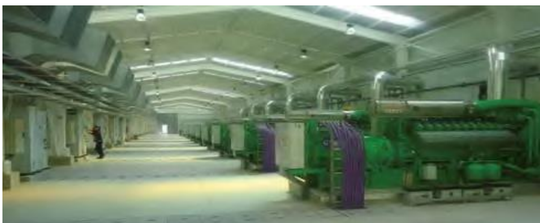
Figura 1.14 Grupos generadores: en contenedor y en casa de máquinas.
