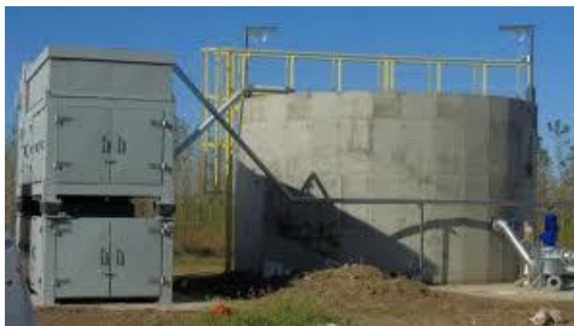
Figura 1.12 Grupos Electrógenos a Biogás.
