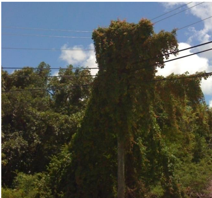
Figura II 2 Imagen de un poste de distribución eléctrica de Central Andros
