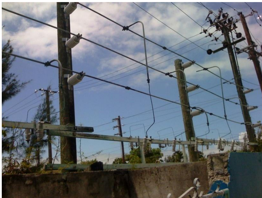
Anexo B -Norte Andros líneas de transmisión eléctrica
