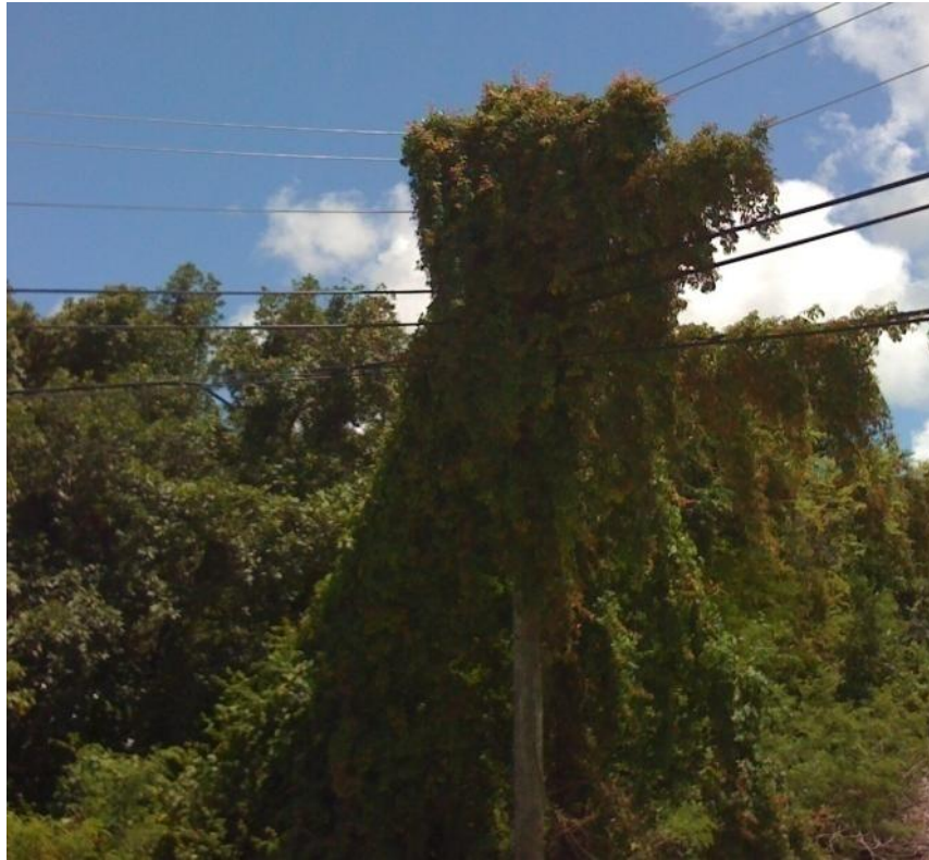
Anexo B -Central Andros líneas de transmisión eléctrica
