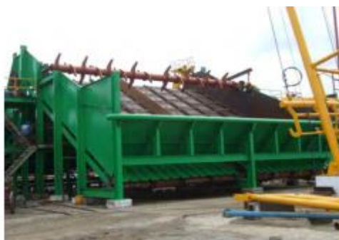
Figura 5: Instalación de una mesa receptora de caña con sistema de limpieza en seco. Fuente: (Ávalos, 2014).
