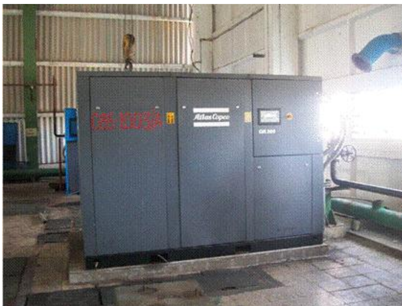
Figura 3.11 Vista General de la Instalación Compresora.
