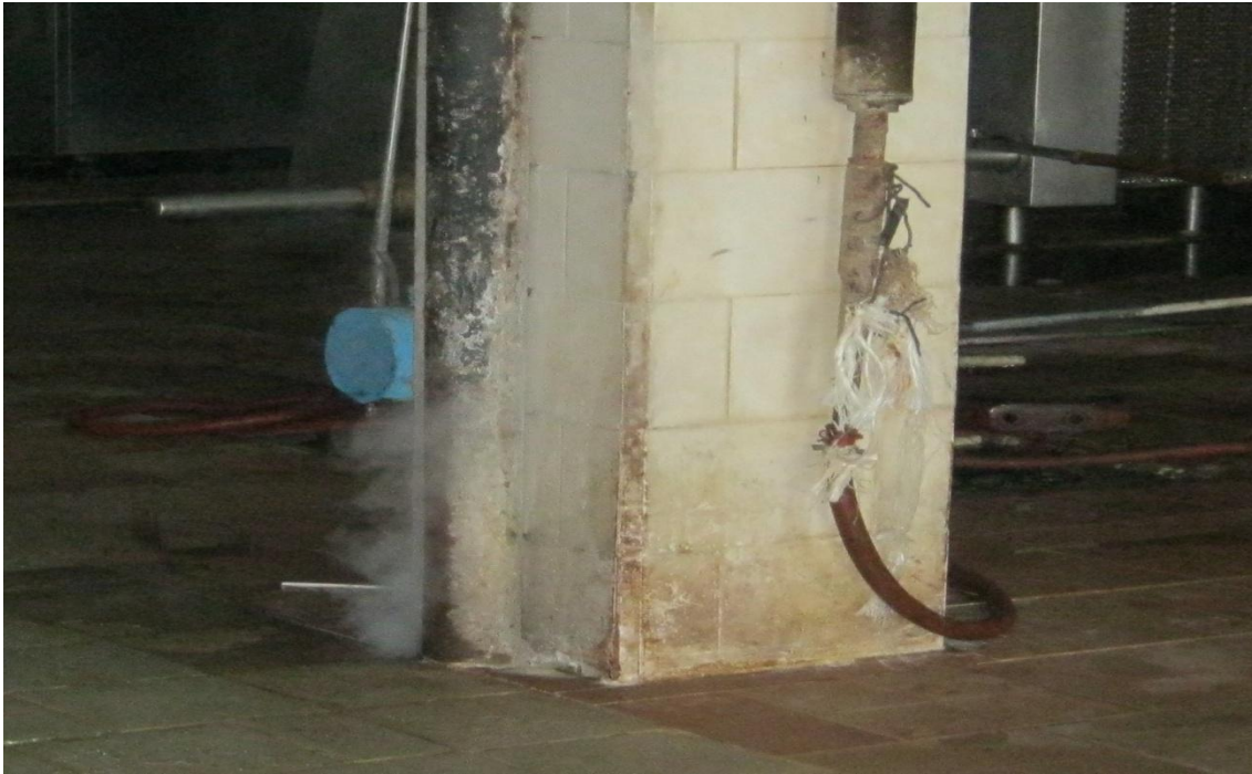
Foto: Salidero de vapor.
