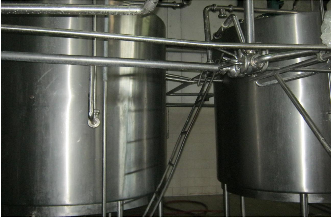
Foto: Tanques de mezcla.
