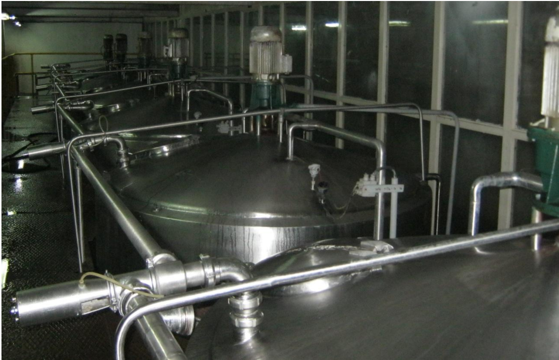
Foto: Tanques de envejecimiento (vista superior)
