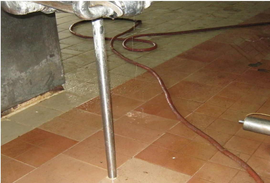
Foto: Salidero de agua.
