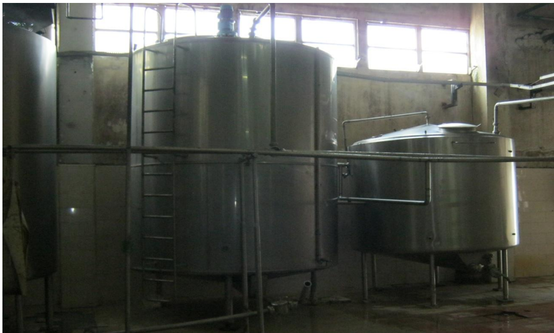
Foto: Tanques de Mezcla.
