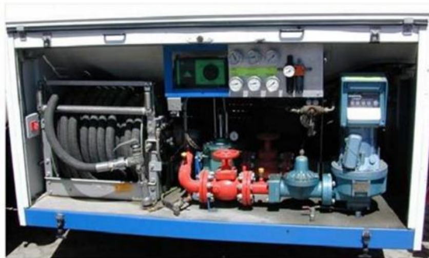
Figura 1.9 Armario de válvulas de carga y descarga. Fuente (Hurtado de Mendoza, 2013)
