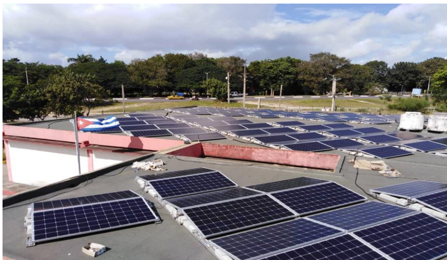
Figura 1.9: Paneles solares fotovoltaicos sobre cubierta en la empresa Copextel Cienfuegos. Fuente (Elaboración propia)
