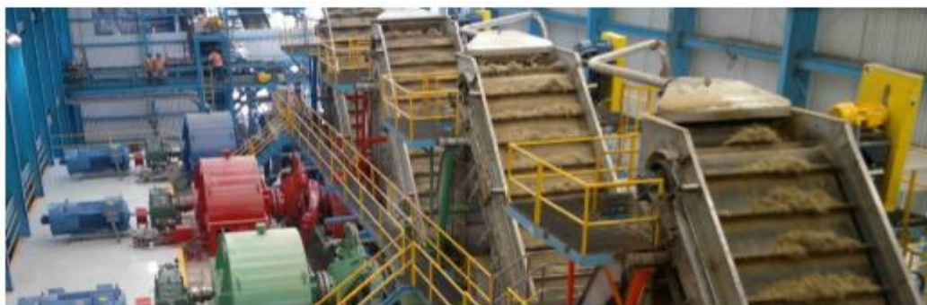
Figura 2. Etapa de molienda de caña. Fuente: (GTI, 2019).
