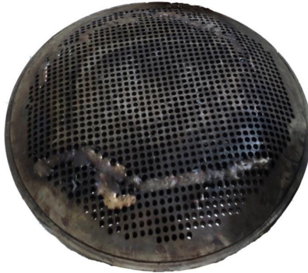
Figura 1.15 Plato perforado Bomba Master MP 2C120 y posición de las grietas y los cordones de soldadura durante su reparación. Fuente: (Borges, 2014)
