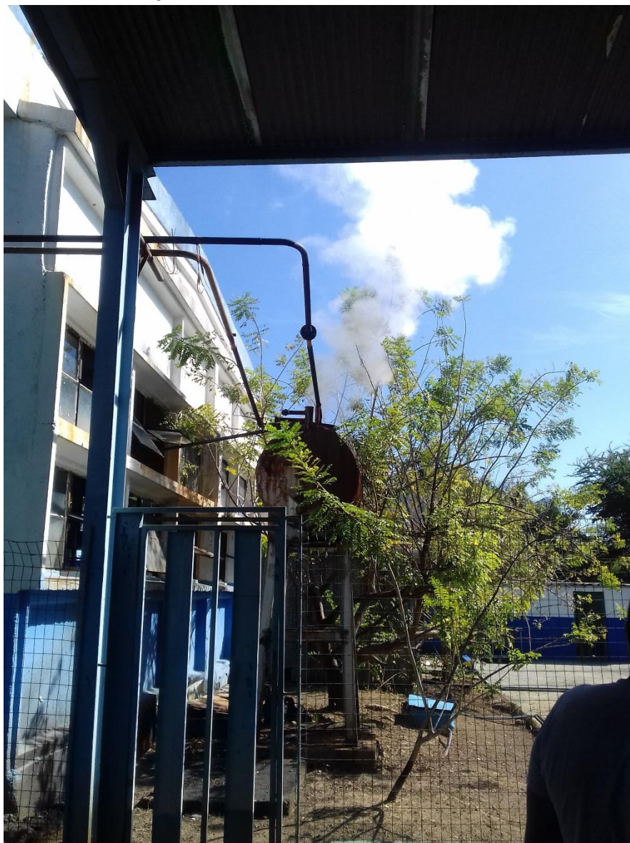
Anexo 4: Tanque de condensado.
