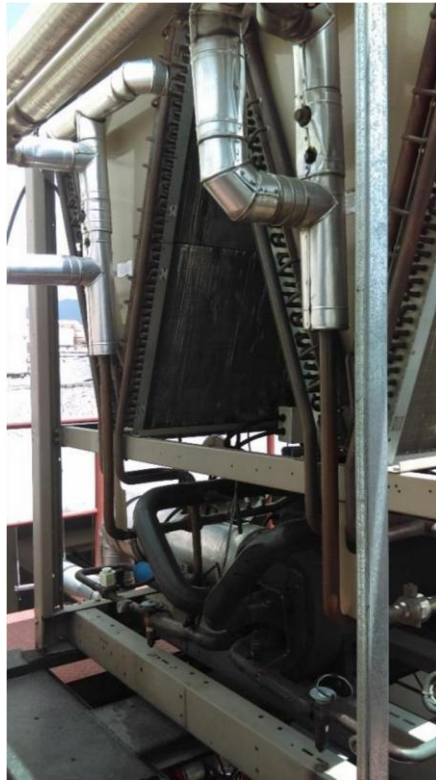
Figura 5. Enfriador de agua (Chiller) (Pérez, 2009)
