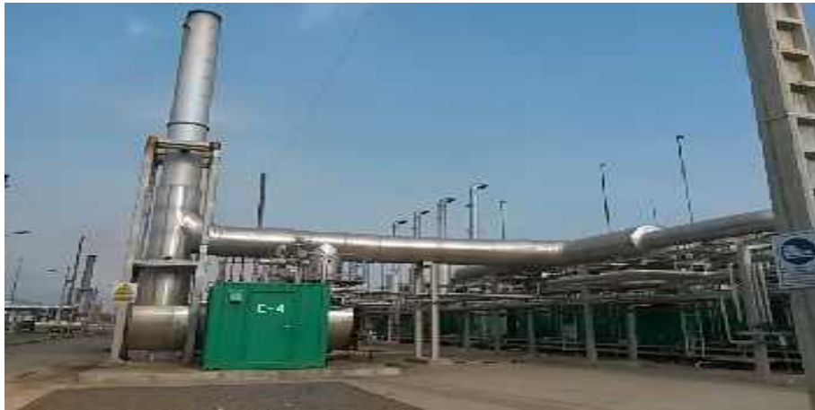
Figura 1.16 Caldera de vapor recuperativa. Fuente: Central Eléctrica Fuel-Oil Yaguaramas.
