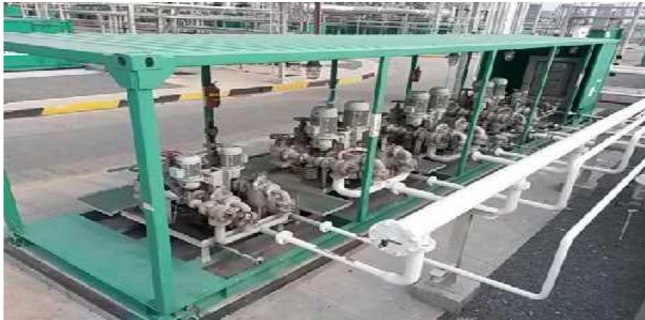
Figura 1.8 Sistema de bombas de alimentación. Fuente: Central Eléctrica Fuel-Oil Yaguaramas.
