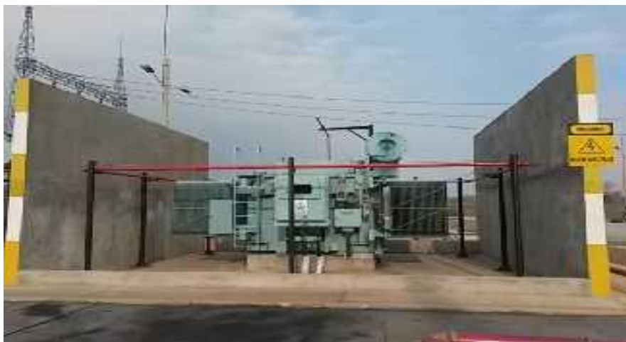
Figura 1.23 Transformador de 33 kV.
