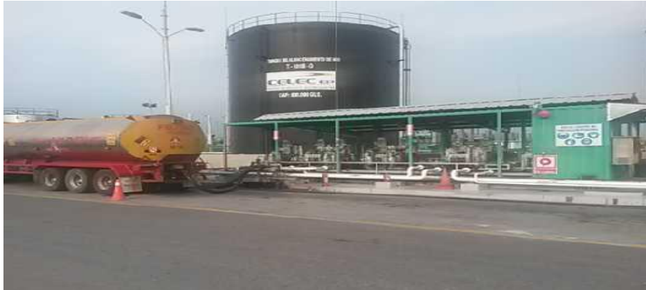
Figura 1.3 Descargue de pailas en el área de recepción de combustible.
