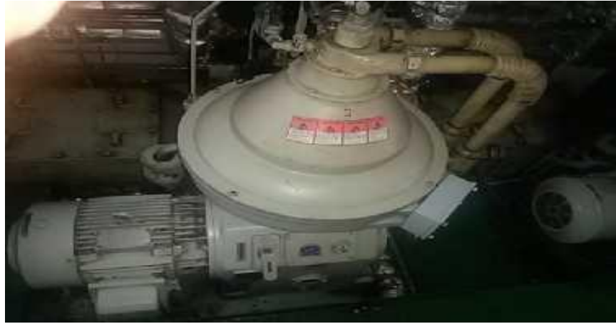
Figura 1.13 Purificadora de combustible HFO (CH30-GOF) Fuente: Central Eléctrica Fuel-Oil Yaguaramas.
