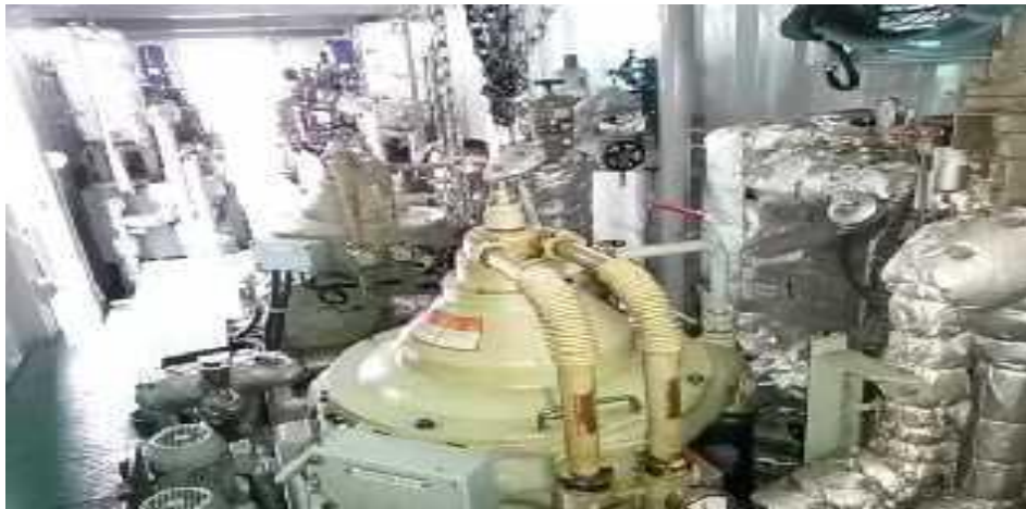
Figura 1.12 Vista interior de la Unidad de Tratamiento de Hidrocarburos (HTU).
