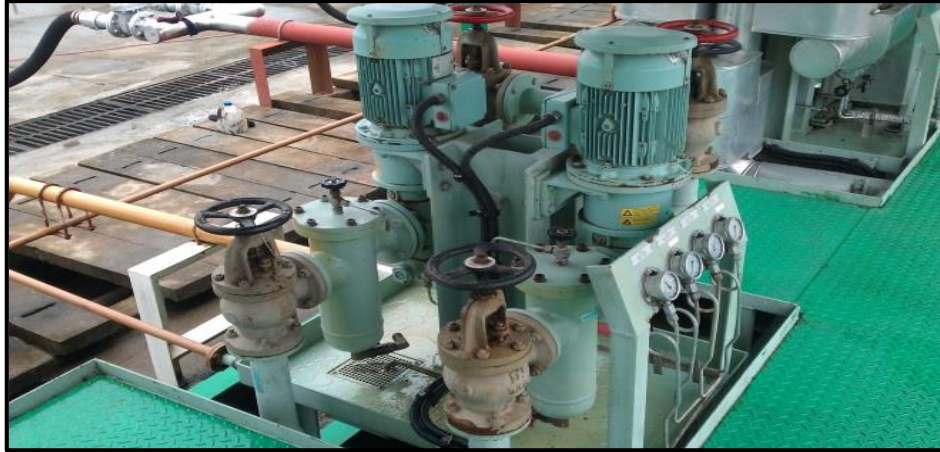
Figura 1.10 Bomba de Trasiego de Diesel. Tipo: Tornillo, Q: 10 m 3 /H, P: 3,5 bar. Fuente: Central Eléctrica Fuel-Oil Yaguaramas.
