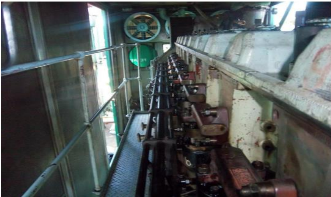
Anexo. 12 Interior del contenedor donde se encuentran ubicado los motores.
