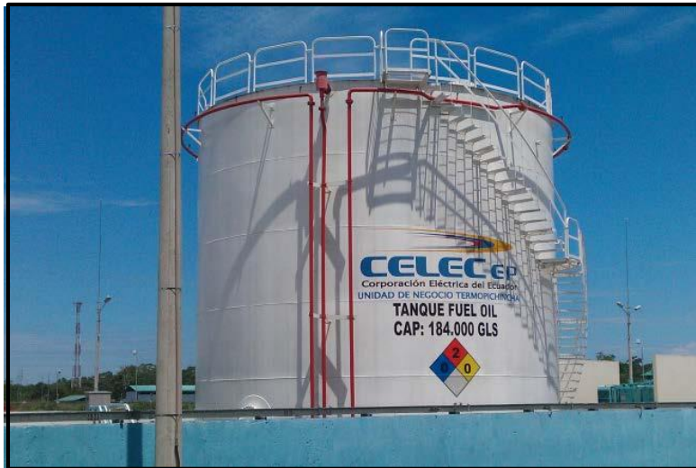
Figura 1.6 Tanque de Fuel-Oil. Tipo API, Atmosférico Vertical, Cap. 700 m 3 Fuente: Planta Termopichincha. Sacha. Ecuador
