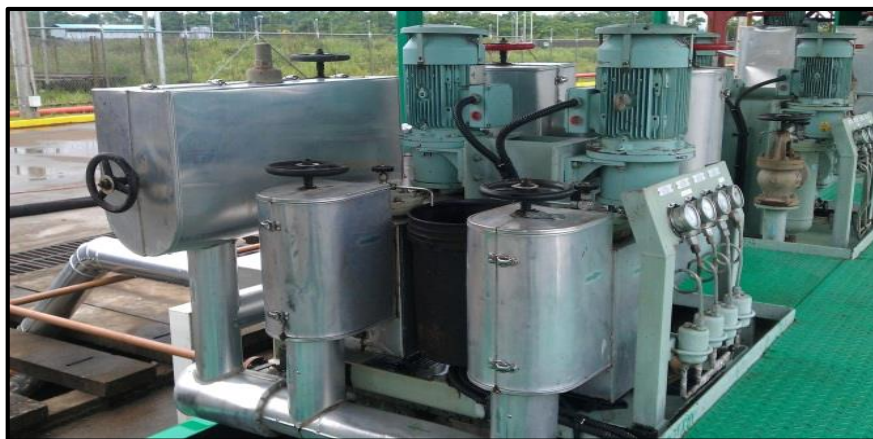
Figura 1.9 Bomba de Traslado de Fuel Oil. Tipo: Tornillo, Q: 10 m 3 /H, P: 3,5 bar. Fuente: Central Eléctrica Fuel-Oil Yaguaramas.
