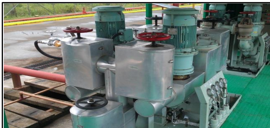
Figura 1.4 Bomba de Recepción de Fuel-Oil. Tipo: Tornillo, Q: 25 m 3 /H, P: 3,5 bar
