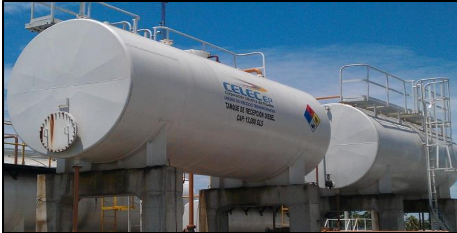
Figura 1.7 Tanques de almacenamiento de Diesel (Cap. 100 m 3 y 80 m 3 ) Fuente: Planta Termopichincha. Sacha. Ecuador.
