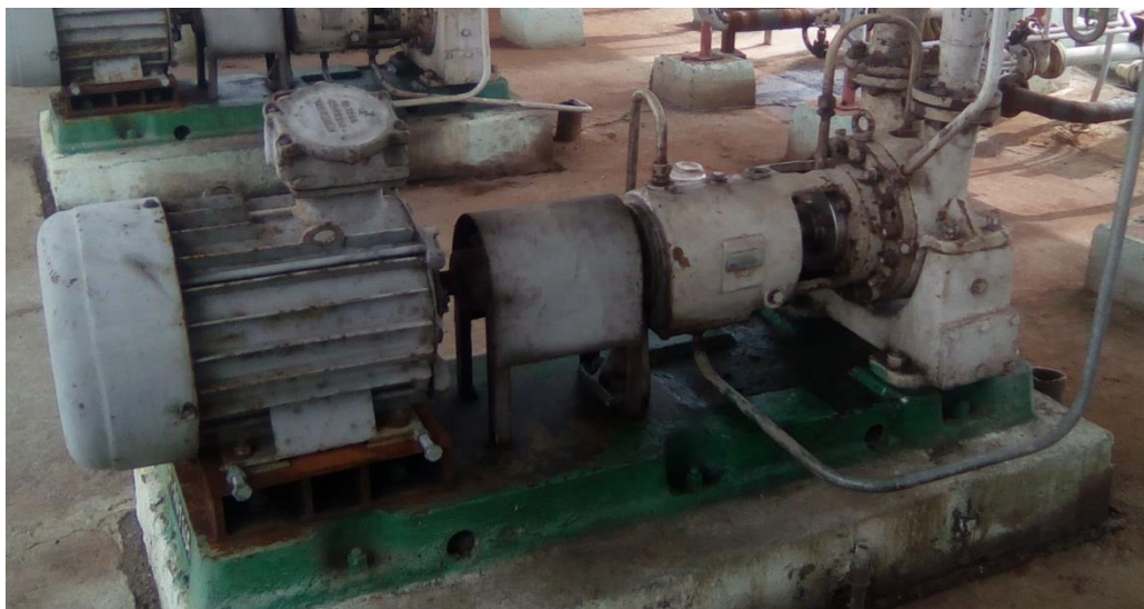
Figura 2.7 Bomba HK 35-65-70 con motor BAO-52-2T2 de fabricación soviéticas instalados en la posición P51-1011.
