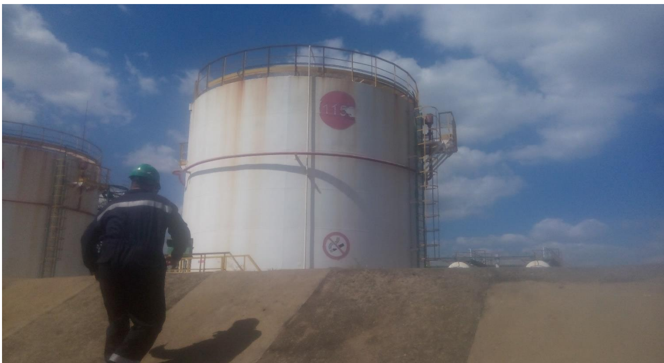
Anexo 3 Depósitos de 700m 3 Tanque 1153 y a la izquierda 1154
