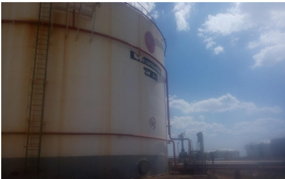
Anexo 9 Tanque de almacenamiento final 1017
