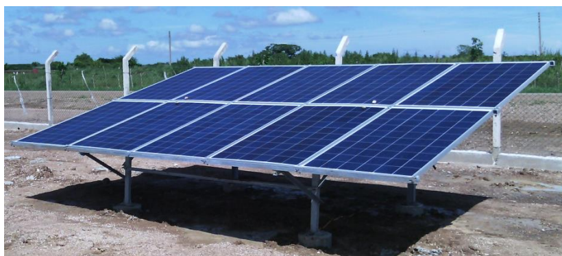
Figura 3.12. Estructura para el módulo fotovoltaico.
