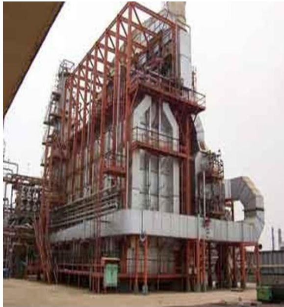
Figura 1.1: Horno de proceso. Fuente: (Ingeniería del calor. 2013).
