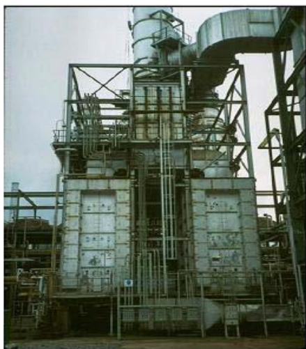
Figura 1.3: Horno tipo cabina. Fuente: (Palacio Toledo, C. I. 2011).
