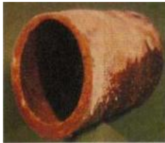
Figura 1.10 Corrosión provocada por los gases de combustión
