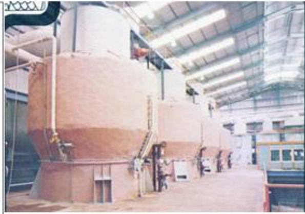
Figura 1.16 Tachos usados en un central Cubano. (Victoria, 2009)
