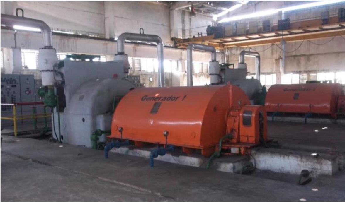
Anexo 5. Turbogeneradores del central Cuidad Caracas.
