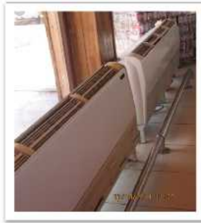
Figura 3.3 Imagen de los minisplits instalados en el mercado
