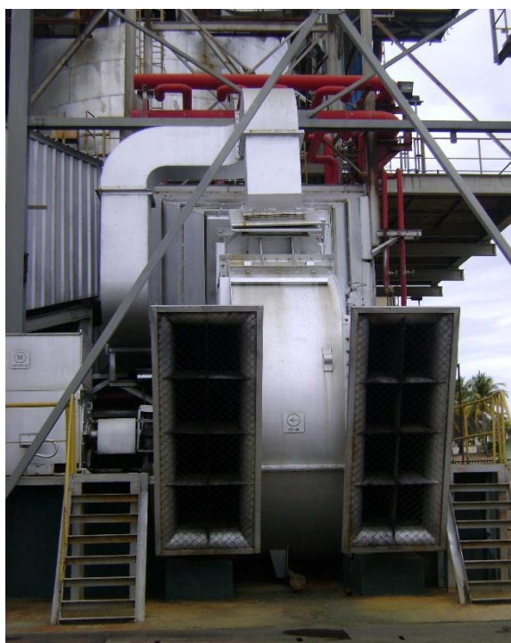
Figura 1.5 Ventilador de tiro forzado 4B ETE Carlos Manuel de Céspedes.
