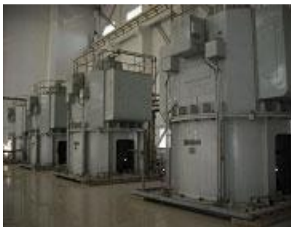
Fig. 1.7 Bombas de agua de circulación para una planta térmica de 1 000 MW propuesta por Hitachi (Hitachi, 2012).
