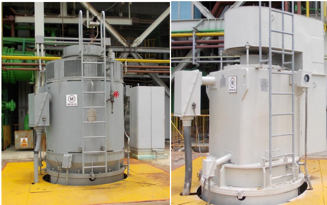
Figura 1.8.Bombas de agua de circulación E.T.E Carlos Manuel de Céspedes U#4.
