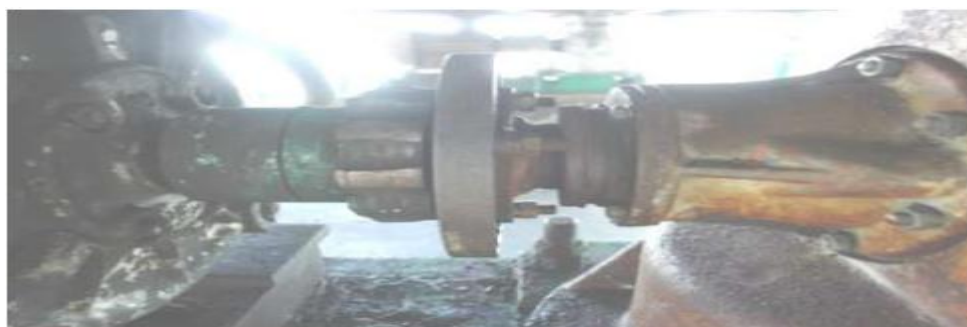
Fig. 1.11 Cizallamiento del acoplamiento del motor.
