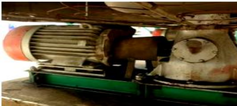
Fig. 1.2 Vista externa del motor eléctrico y el reductor.
