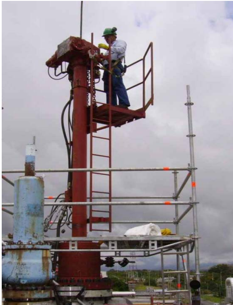
Fig. 1.2 Hot Tap en una perforación de diámetro 30 pulg.
