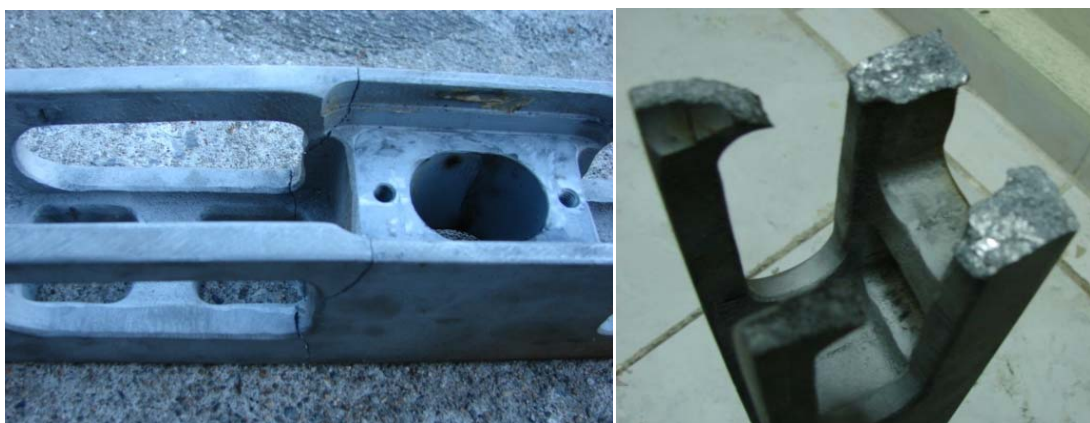
Fig. 1.16. Grieta en la barra superior.
