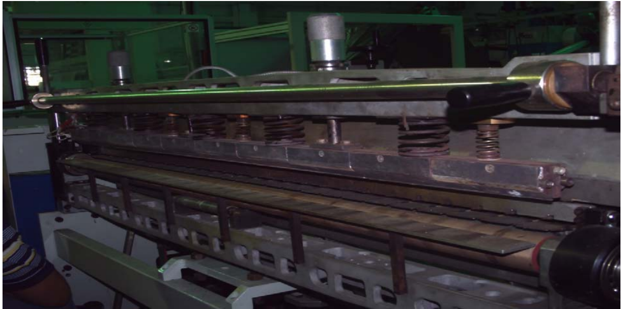
Foto 1. Barra superior e inferior junto al conjunto de de apoyos elásticos.
