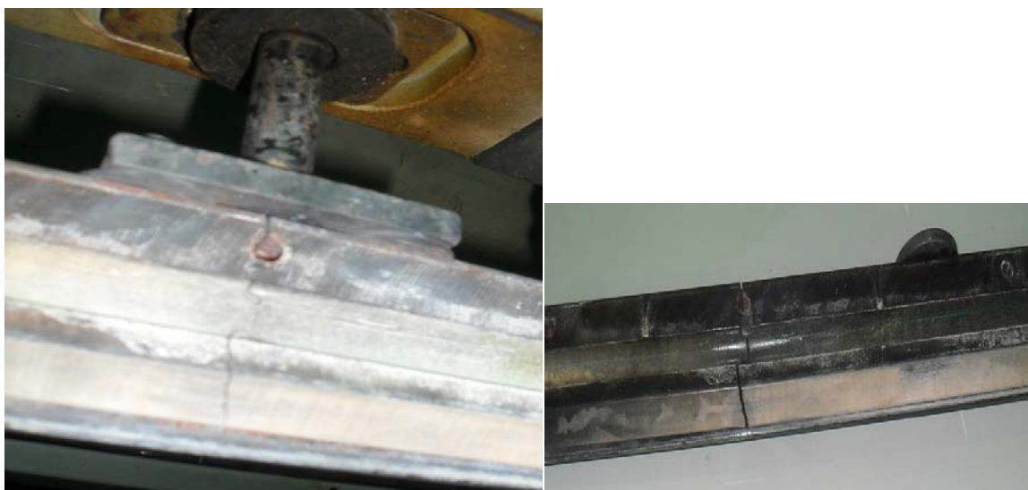
Foto 6. Fractura de la barra inferior.
