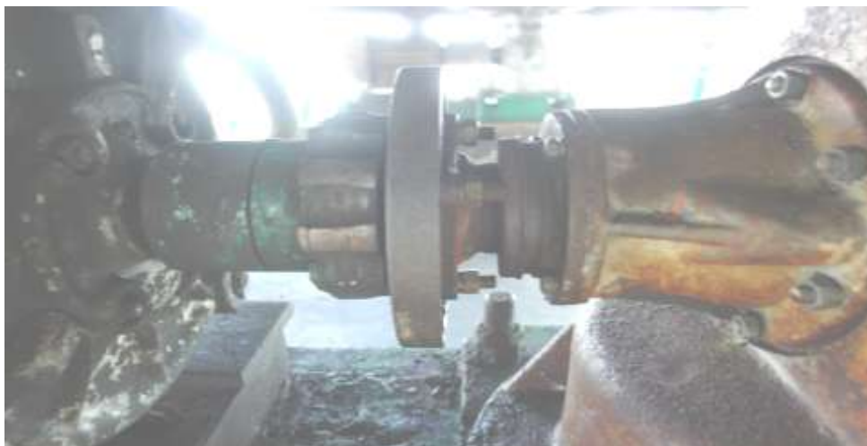
Fig. 1.11 Cizallamiento del acoplamiento del motor.
