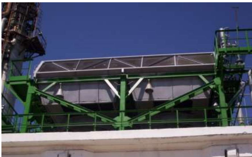
Fig. 1 Vista de los difusores originales antes de la reactivación.
