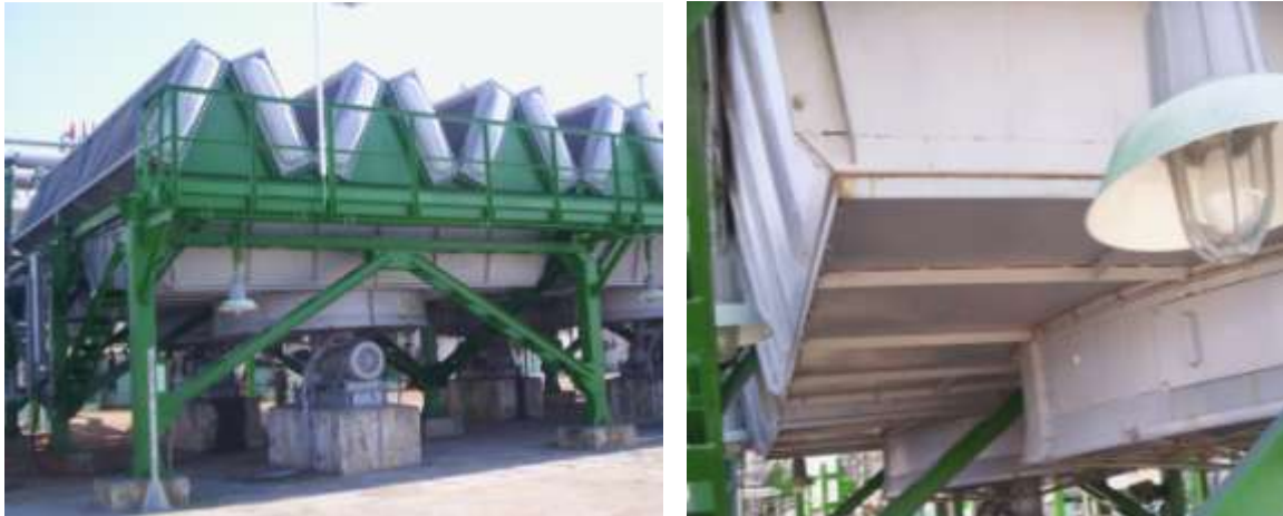
Fig. 2. Vista de los difusores reconstruidos producto de la reactivación.
