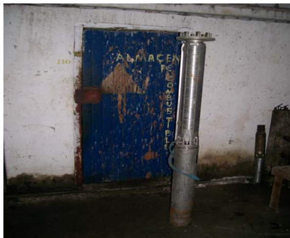
Figura 1.2 Bomba marca Wilo centrifuga vertical sumergible.
