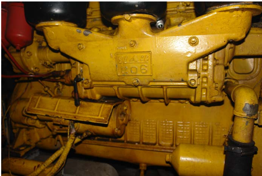
Fig. 3.7 Vista del Motor YAV 206 de las Bombas
