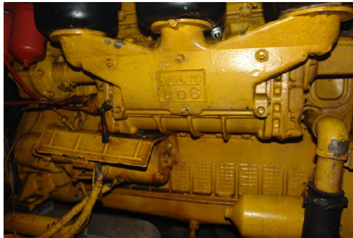
Fig. 2.11 Vista del Motor YAV 206 de las Bombas
