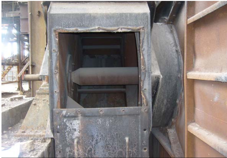
Foto 3: Vista del eje del ventilador
