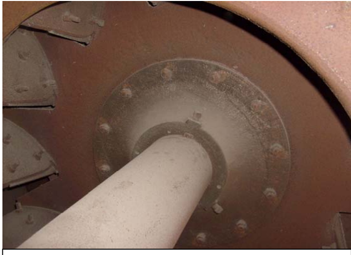
Foto 5: Vista del acoplamiento eje-impelente
