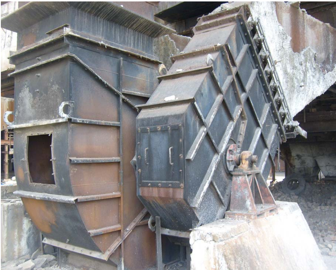
Foto 1: Ventilador de doble succión para el tiro inducido. (Mexicano)
