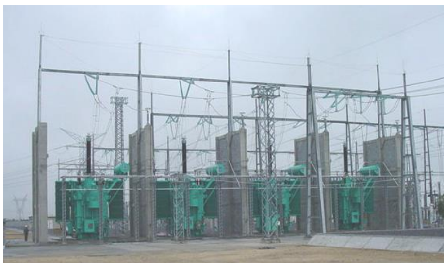
Figura 2.5: Subestación de la ECIE. Fuente: (Elaboración propia)
