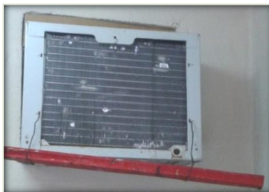
Figura 8: Climatización del área del Lunch. Fuente: Elaboración propia
