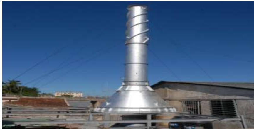
Figura 2.13: Chimenea actual instalada en la Torrefactora. Fuente: Empresa Torrefactora y Distribuidora de Café de Cienfuegos.
