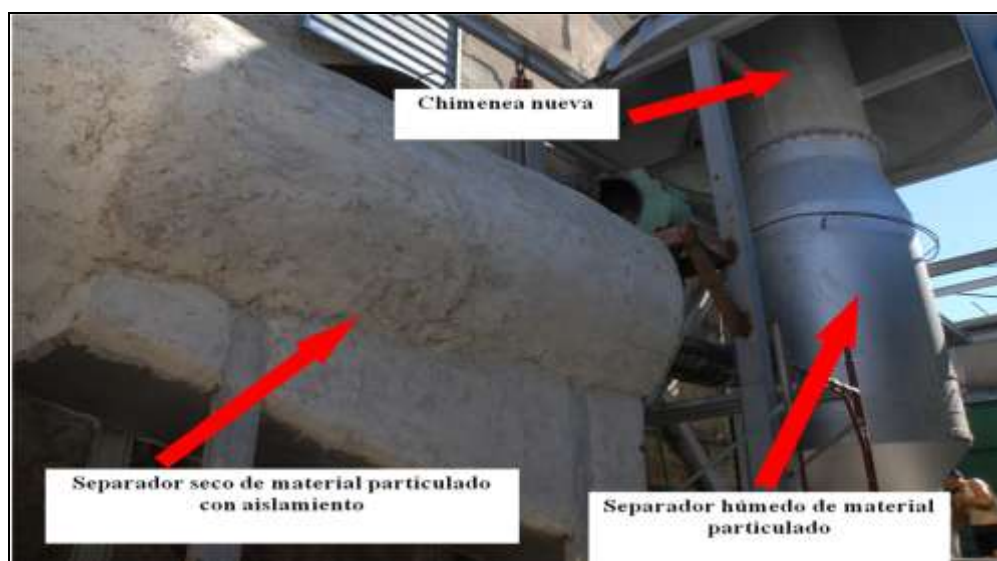
Figura 2.12: Separador seco y Separador húmedo. Fuente: Empresa Torrefactora y Distribuidora de Café de Cienfuegos.
