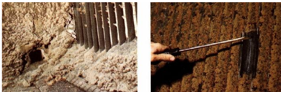
Figura 3.13: Comparación de las incrustaciones en las paredes del condensador sin aditivo (izquierda) y con aditivo (derecha). Fuente: Dirección Provincial de Generación.
