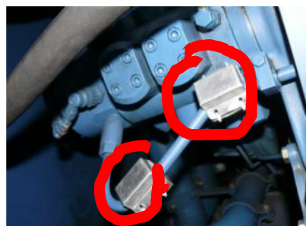
Figura 3.16: Magnetizadores DIMAG en motores diesel a la salida de la bomba de combustible. Fuente: Dirección Provincial de Generación.
