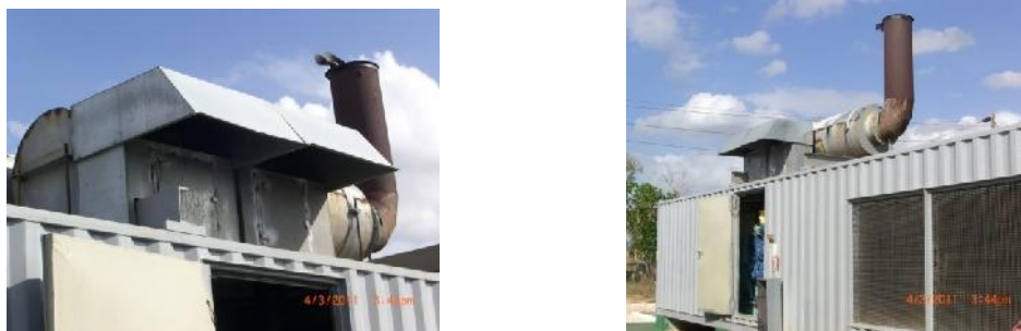
Figura 3.12: Filtros de aspiración incorporados a los contenedores. Fuente: Dirección Provincial de Generación.
