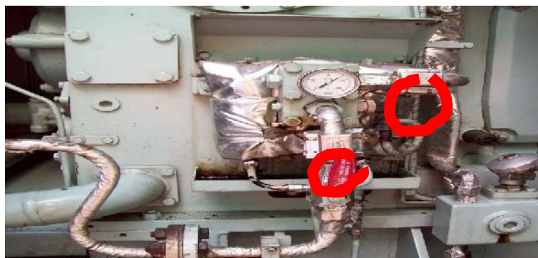
Figura 3.17: Magnetizadores DIMAG en sistema de combustible Hyundai a la entrada del combustible al motor. Fuente: Dirección Provincial de Generación.
