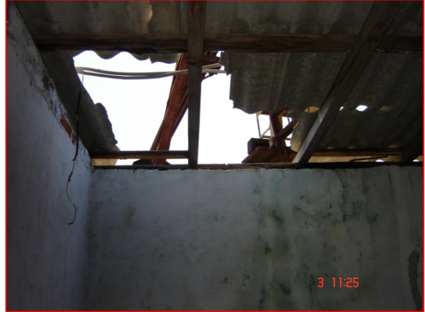
Afectaciones significativas en los techos
