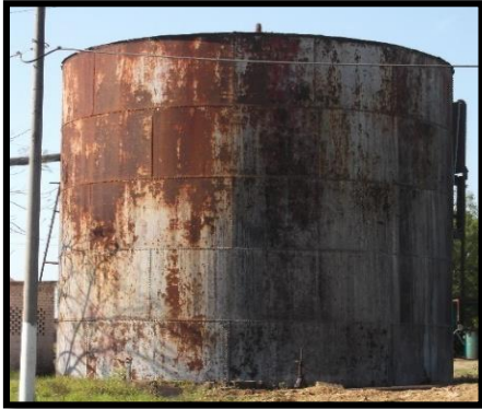
Tanque de combustible
