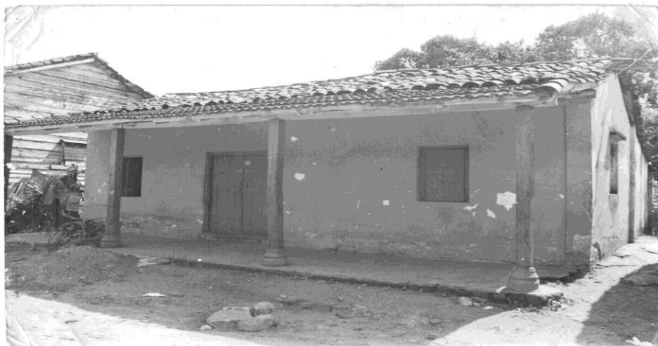
Antes de ser reparado
