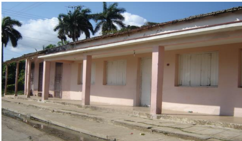
Antes de ser reparada
